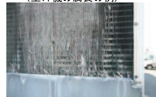
（室外機の腐食の例）
