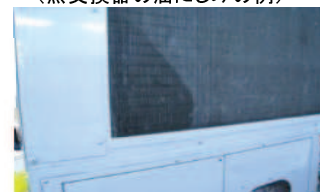
（熱交換器の油のにじみの例）
